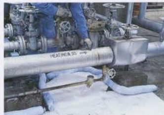
作業中の漏油に
